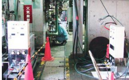
地熱発電所タービン油（SRC-8110-162V, -816-22V）
